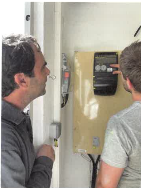
Mise en service de la centrale
