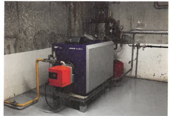
Des fonctionnements de chaudières à optimiser
