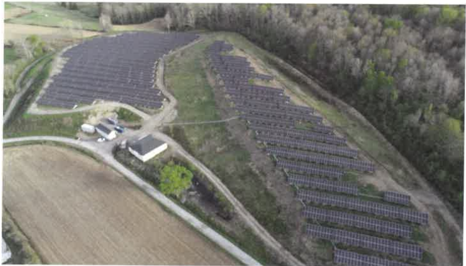
La centrale de Bénéjacq vue du ciel
